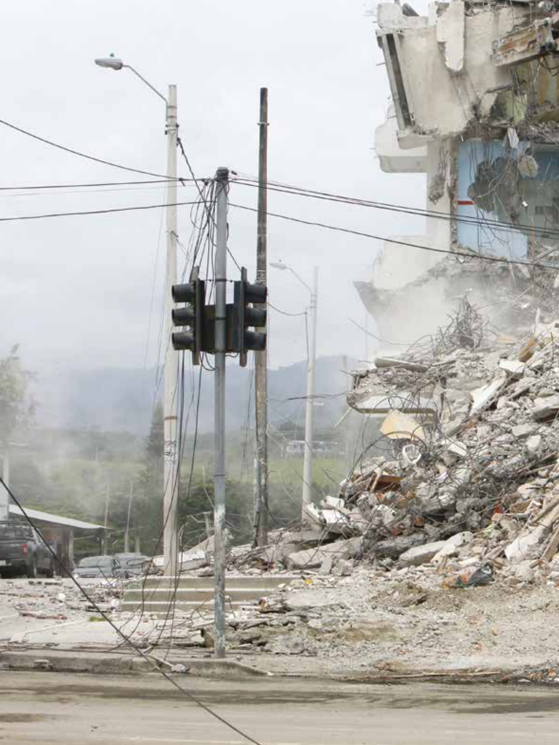
Pedernales fue la población más afectada. Un 80% de esa urbe quedó en ruinas
